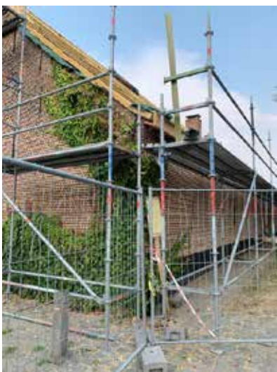
▲ De renovatie van de Krankhoeve mag geen extra brandrisico's met zich meebrengen.
